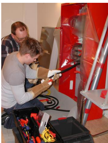
Övning i kabelskåp
